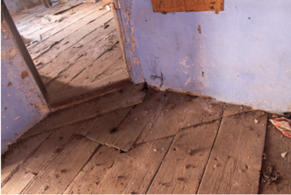
Şekil 10: Döşeme üzerinde odanın eski sınırlarını gösteren izler
